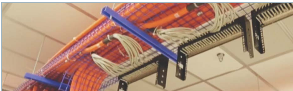
Le nouveau Data Center à Nairobi
