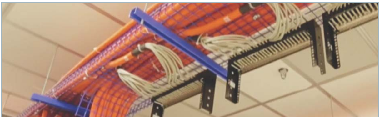
Le nouveau Data Center à Nairobi
